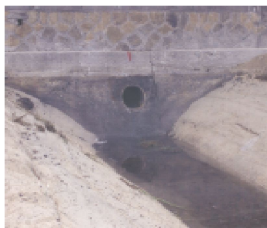
萩原団地の入り口の排水対策 萩原団地の排水路の末端、線路の沖が砂で塞がれ排水困難、JRが除去
