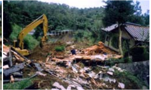
山陽自動車道現場、一階部分は土砂の下
