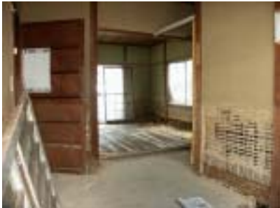
床上浸水で家具等も全部廃棄処分した民家
