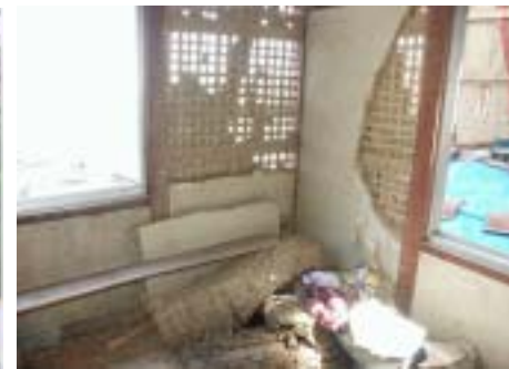
窓が割れ壁が落ちているAさん宅
