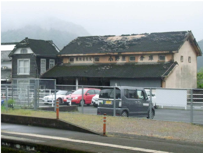
瓦の崩落した倉庫（大分県）
